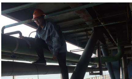
Подвесной трубопровод в химии и нефтехимии
