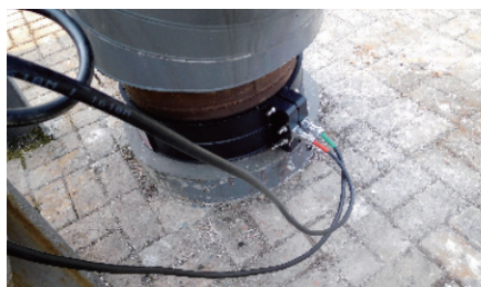
Заходы трубопровода в землю
