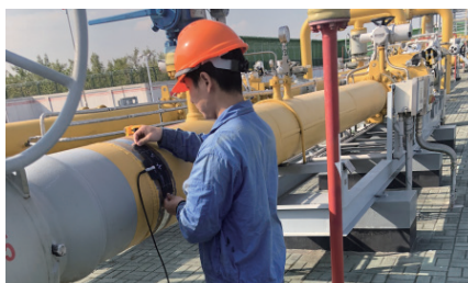
Трубопровод природного газа
