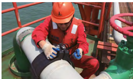
Трубопровод морской платформы
