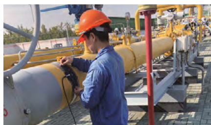
Трубопровод природного газа
