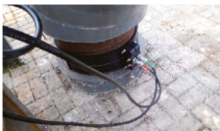
Заходы трубопровода в землю
