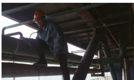
Подвесной трубопровод в химии и нефтехимии
